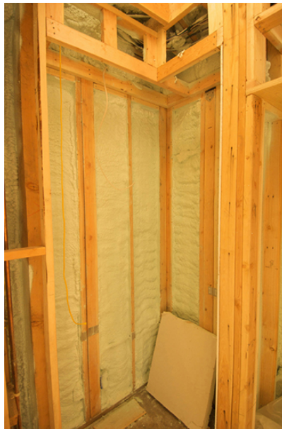
Figura 1.20. El aislamiento se usa para limitar la conducción de calor desde el interior hacia el exterior (en invierno) y desde el exterior hacia el interior (en verano). (crédito: Giles Douglas)
