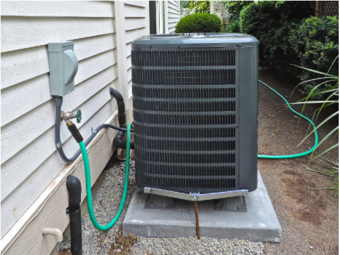
Figura 4.15. Una fotografía de una bomba de calor (caja grande) ubicada fuera de una casa. Esta bomba de calor está ubicada en un área de clima cálido, como el sur de los Estados Unidos, ya que sería demasiado ineficiente en la mitad norte de los Estados Unidos. (crédito: modificación del trabajo por Peter Stevens)
